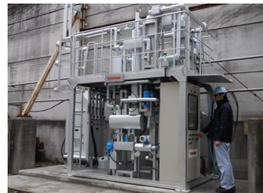
出所：日経XTECH「CO 2 削減の切り札CCS、セメント工場の排ガスからも回収開始」 キルンの排ガスからCO 2 を分離回収する装置（太平洋セメント）
